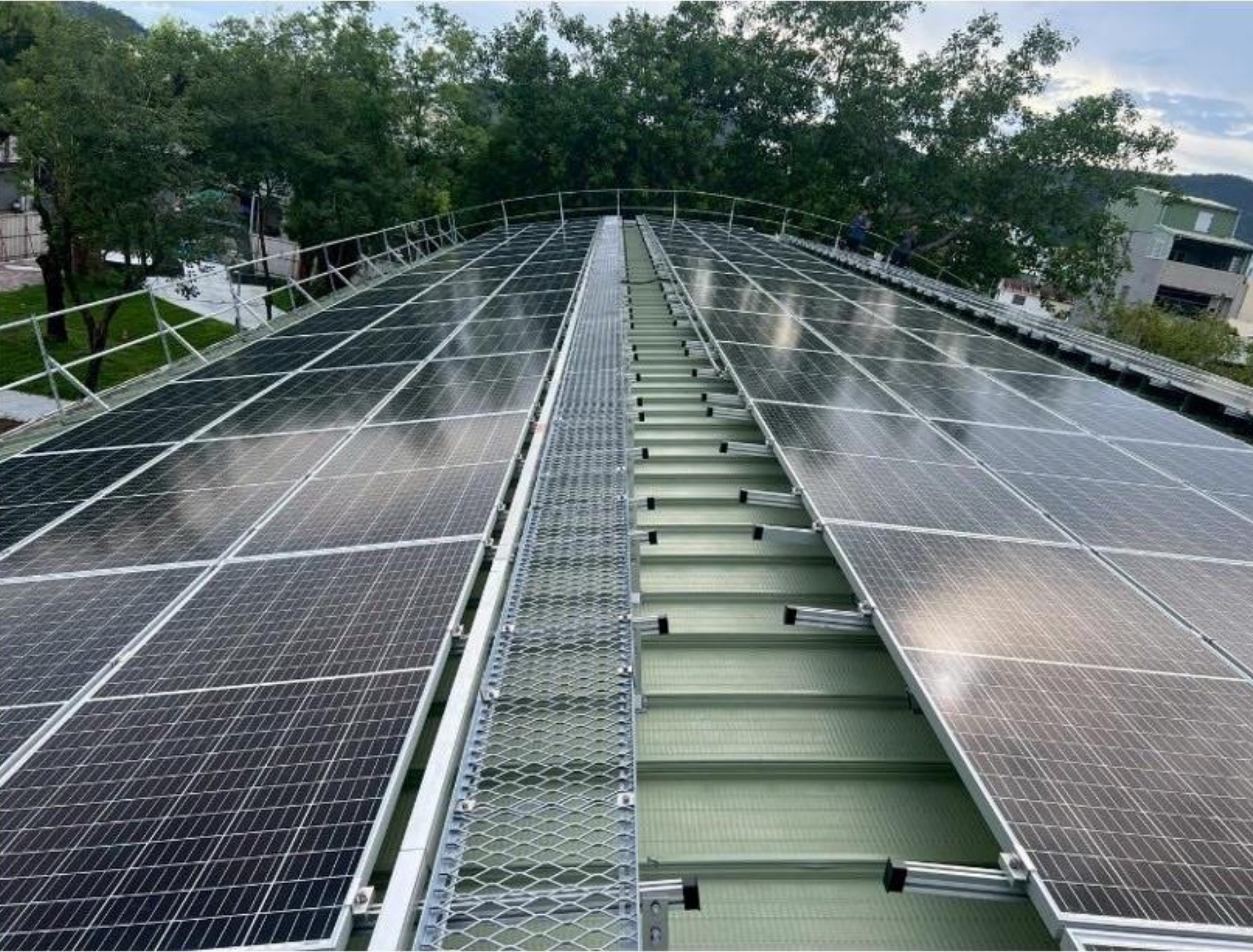
楠西區 光電系統完工
