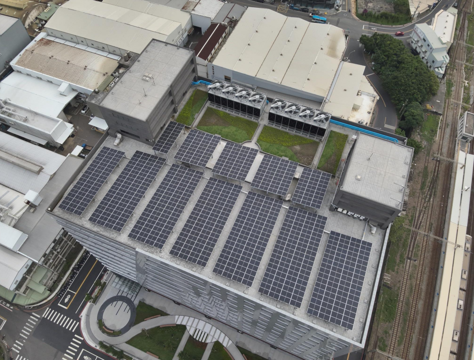
湖口鄉廠辦 光電系統完工
