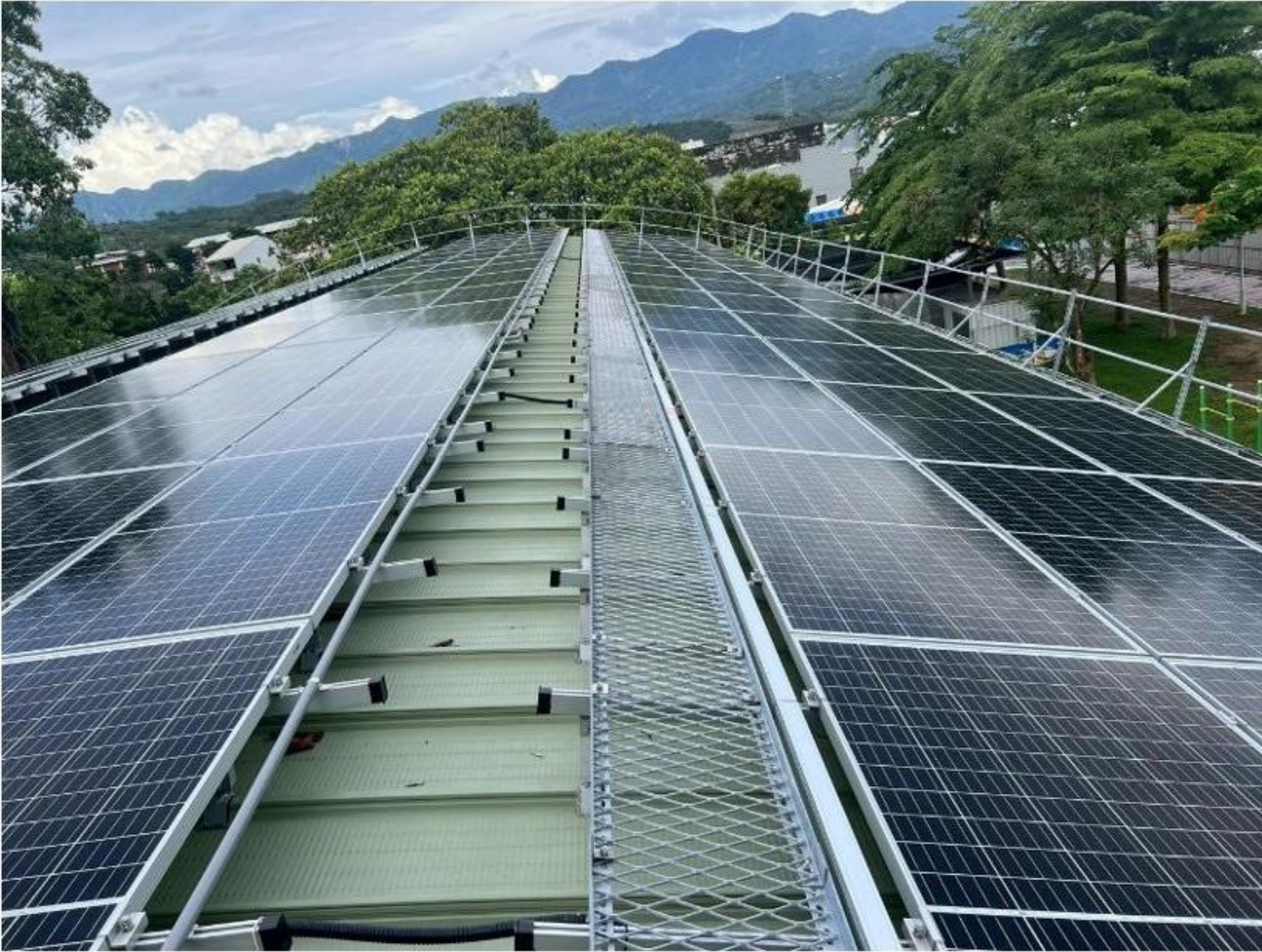
楠西區 光電系統完工
